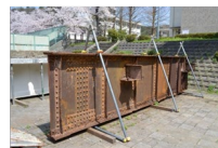
二十六木橋の桁端部 (CAESAR提供)
