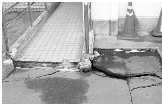
写真2 保健管理センター入口の地割れ、陥没
